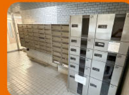
宅配ボックス
